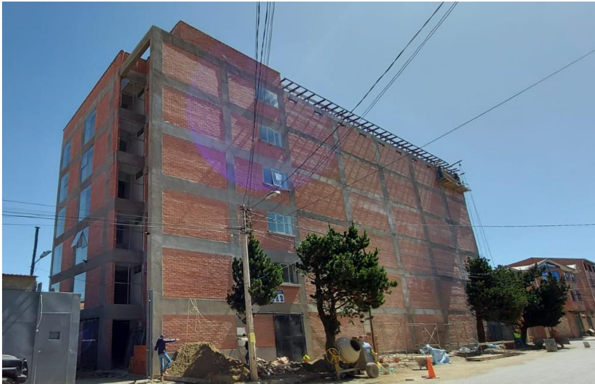
Ampliación, construcción y adecuación de nuevos ambientes en el archivo ciudad de El Alto - La Paz
